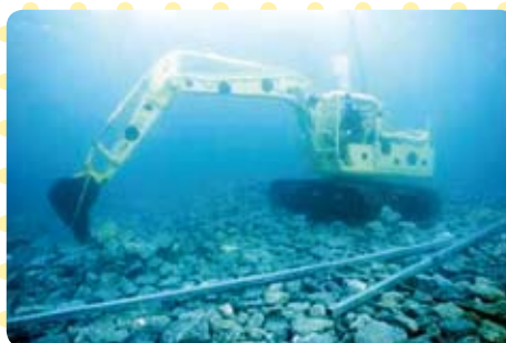
水中で石を均す油圧ショベル (写真提供：東亜建設工業株式会社)
